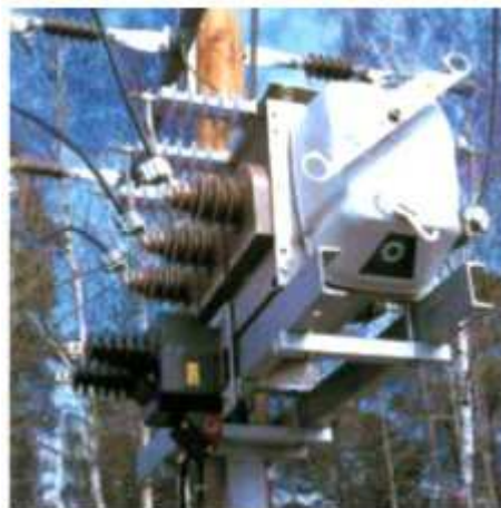
Rozłącznik Sectos NXB (ABB) z zainstalowanymi sensorami prądu KOKU 072G4 600/1A
